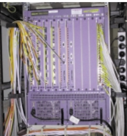
■ „Nabe“ des Gigabit Ethernet-Systems bei der WP: Core Switch Black Diamond 6808 von Extreme im Rechenzentrum
